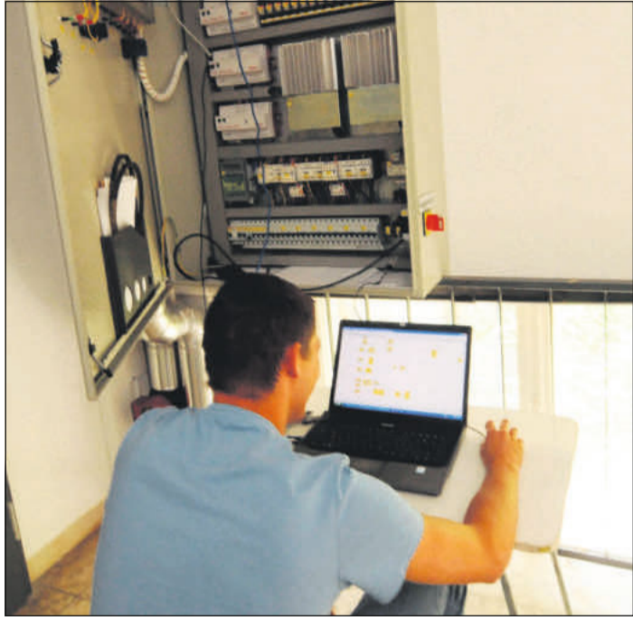
Ohne Strom kein Smart Home - deswegen kann auf Elektroniker für Energie- und Gebäudetechnik nicht verzichtet werden.
