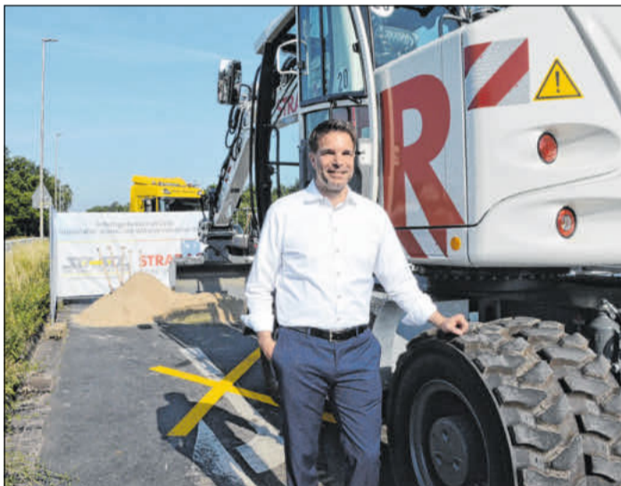
OB Dr. Jörg Nigge gab den Startschuss für die Baumaßnahme. Foto: Kirakossjan
