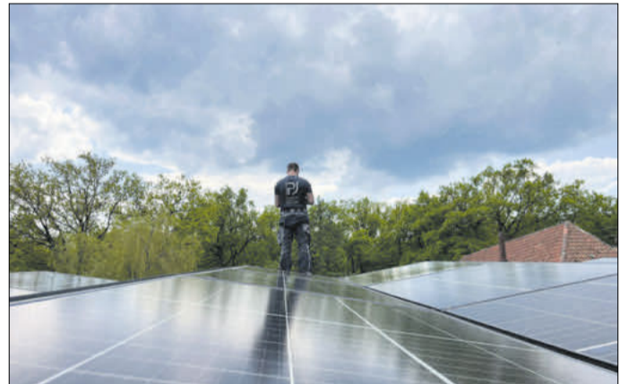
Blick auf eine Photovoltaik-Anlage.
