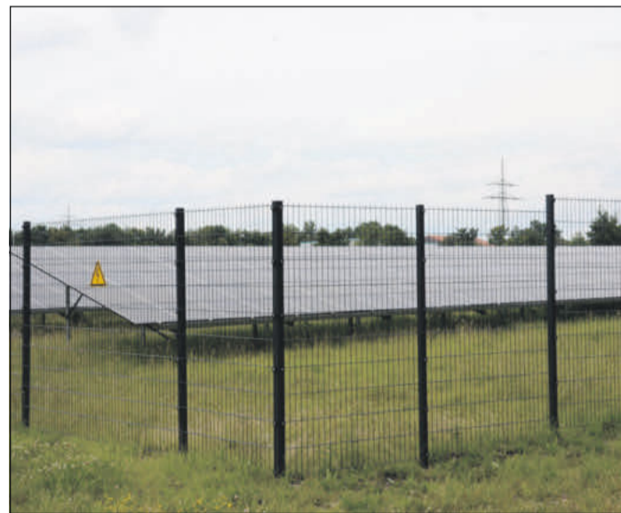
Es wurde auch über Photovoltaik gesprochen.
